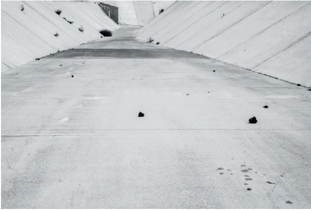
Fig. 5. Infraestructura de concreto para la salida del agua. Oswaldo Ruíz, 2021, Santa Catarina, Nuevo León, México.
